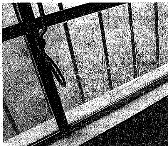
Janela. Vidro danificado expõe alunos a riscos
